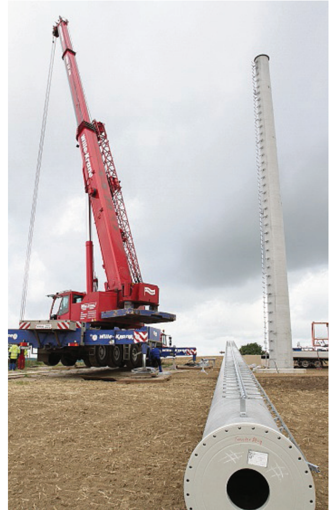
Gestern wurde auf dem Trenter Berg zwischen Plön und Preetz der neue Funkturm errichtet. MICHAEL KUHR
