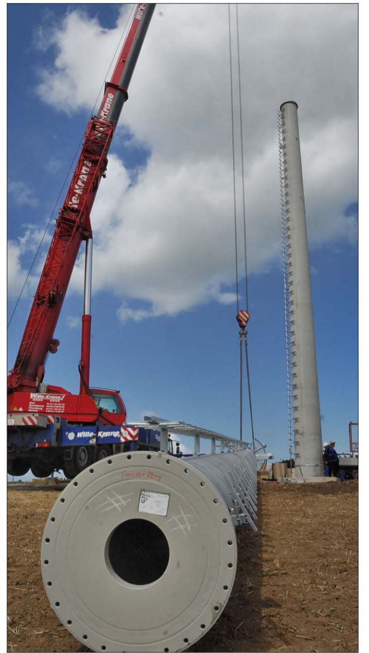
Der obere Teil des Funkmastes liegt bereit und wird für die Montage auf der gleichlangen 20 Meter hohen Basis vorbereitet.
